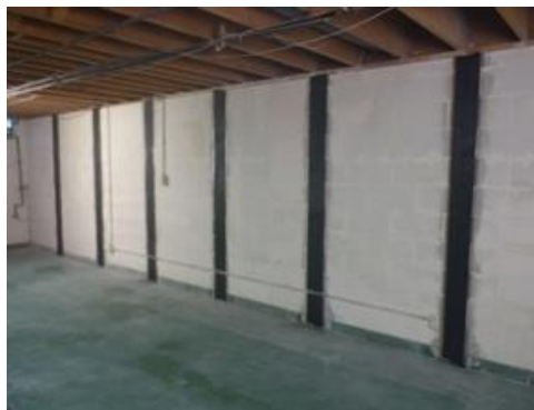
รูปที่ 10 การเสริมความมั่นคงแข็งแรงโครงสร้างกำแพงโดยใช้ระบบ FRP แบบแผ่นเส้นใยแห้ง (ที่มา : https://www.frontierbasementsystems.com/foundation-repair/foundation-repair-products/wall-reinforcing-systems.html )
