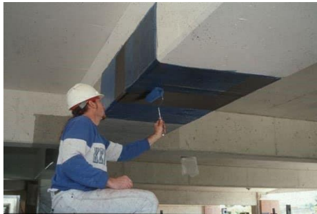
รูปที่ 4 การติดตั้งแผ่น FRP ที่ด้านข้างโครงสร้างคานเพื่อเพิ่มกำลังรับแรงเฉือน
